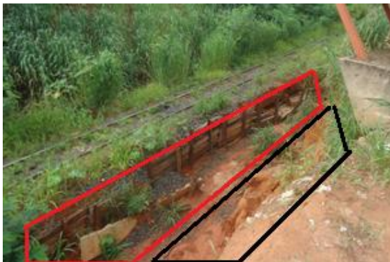
Figura 1. Impactos ocasionados por águas pluviais urbanas em plataforma de via férrea.
