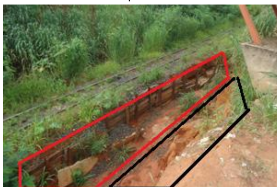
Figura 1. Impactos ocasionados por águas pluviais urbanas em plataforma de via férrea. Erosão – delineada em vermelho. Talude de corte – delineado em preto.
